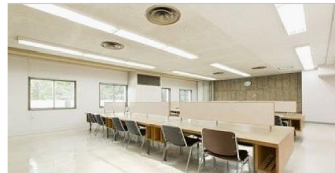
会議室 LED 照明
