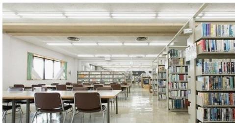
図書館 LED 照明
