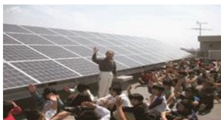
屋上太陽光パネル
