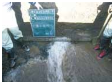
老朽化した配水管から漏水
