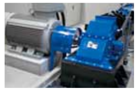
金山沢川水力発電所 (年間約50万kWh)
