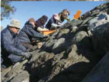
上:発見された木工沈床と徳島堰暗渠の天井部 下:石積み調査風景
