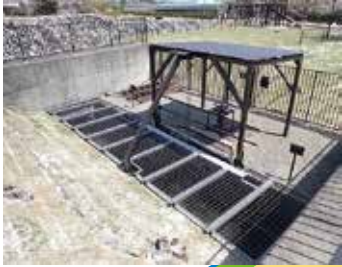
水路蓋 (安全対策)
