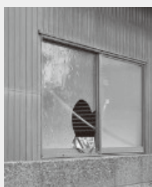
窓が割れた管理不全空家
