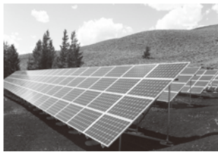
太陽光発電施設
