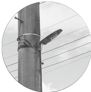
市内の防犯灯
