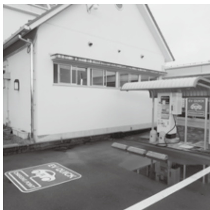
道の駅しらねに設置してある急速充電設備
