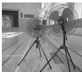
学校の体育館に設置してある大型扇風機
