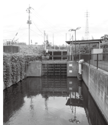
サイホン式になっている井路縁川の樋門
