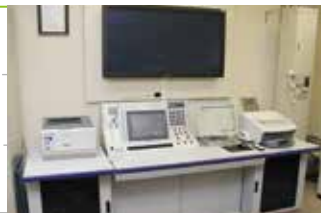
防災行政無線設備
