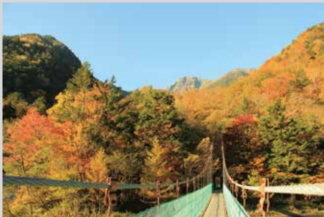
⑧ 吊り橋と野呂川沿いの紅葉。散策路としても楽しめます。
