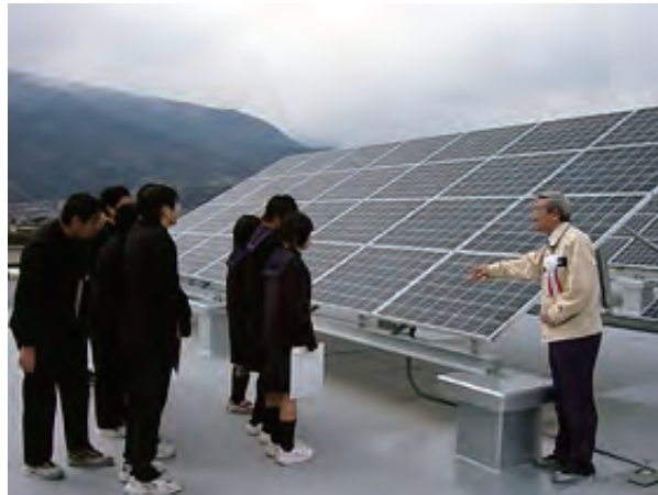
TDK 甲府工場の太陽光パネル (出典:TDK ホームページ)
